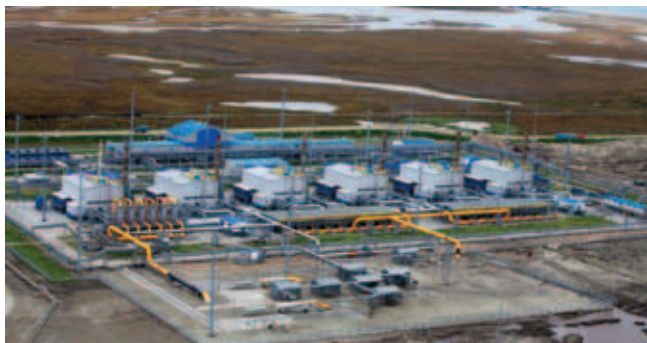
Компрессорная станция «Байдарацкая» (газопровод «Бованенково – Ухта»)
