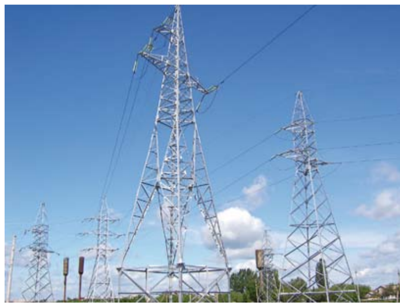
Опоры ЛЭП на подходах к ПС «Северная», Белгород
