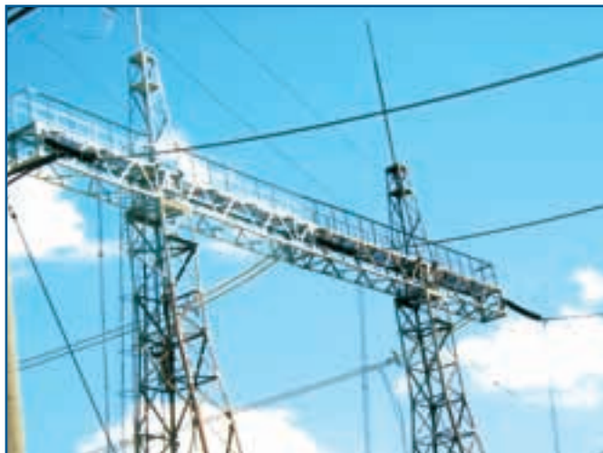
ПС «Липецкая», металлоконструкции опор ЛЭП
