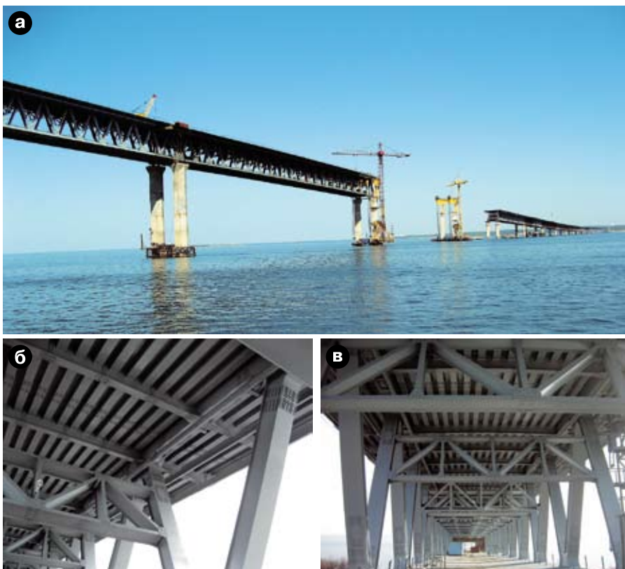
Рис. 2. Строительство мостового перехода через р. Волга в г. Ульяновске: а) общий вид пролетов; б) покрытие ЦИНОТАН + ПОЛИТОН-УР + ПОЛИТОН-УР (УФ) после 1 года эксплуатации; в) грунтовка ЦИНОТАН после 4 лет эксплуатации на объекте
