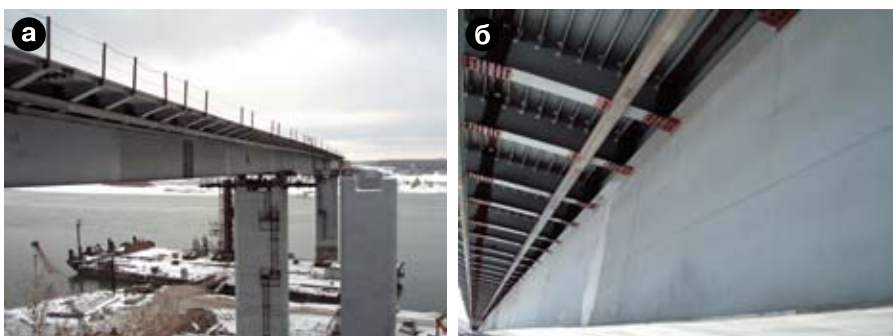
Рис. 3. Строительство мостового перехода через р. Обь у пос. Красный Яр около Новосибирска: а) общий вид, грунтовка ЦВЭС; б) грунтовка ЦВЭС после эксплуатации в течение 5 лет (монтажные стыки – грунтовка ФЛ-03К)
